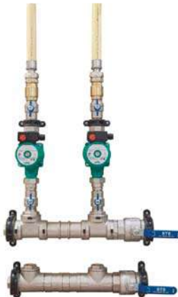
ج- سیستم انشعاب پمپ‌های موتورخانه
