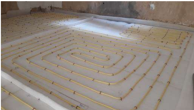
شکل ۳-۷۵: نمونه اجرای گرمایش از کف ساختمان مسکونی
