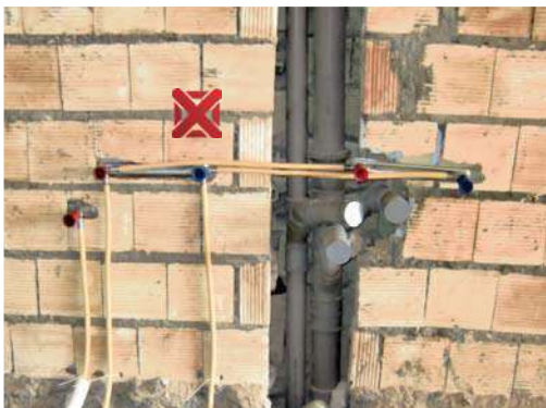
شکل ۴-۱۴: اجرای غلط- حرکت لوله به صورت افقی بر روی دیوار
