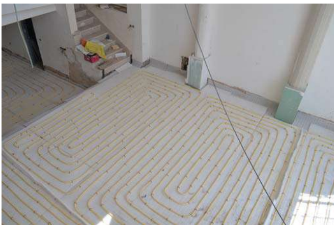
شکل ۳-۷۶: نمونه اجرای گرمایش از کف ساختمان مسکونی
