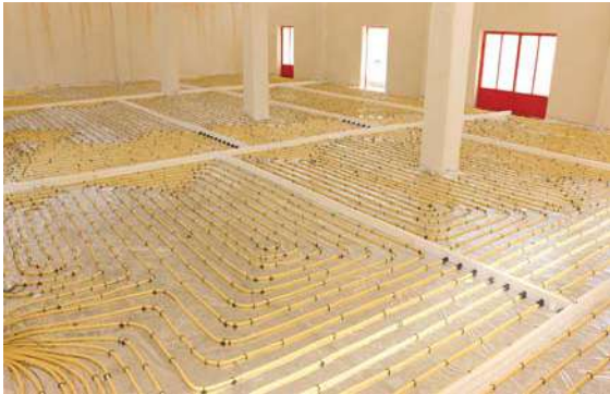
شکل ۱-۳: گرمایش از کف اجرا شده در محیط نیمه صنعتی
